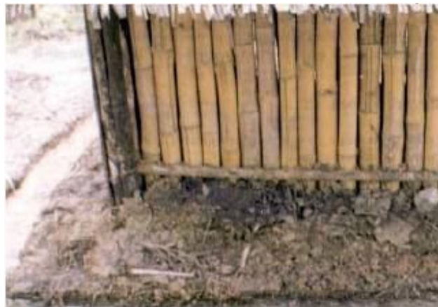
Ilustración N° 9: Instalación rustica con paredes de bambú. Obsérvese la zanja para derivar el agua de lluvia.
